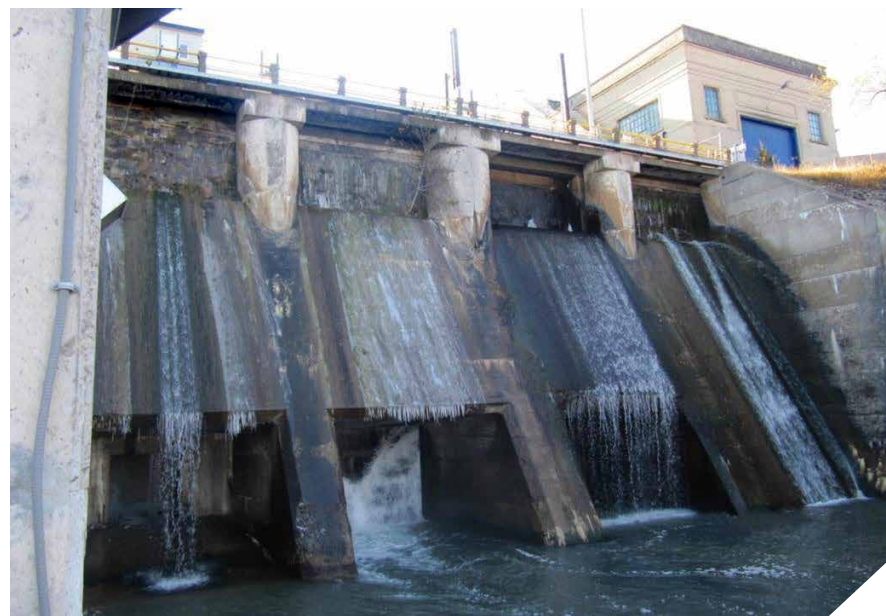
Vue du fonctionnement de vannes de déversoir.
