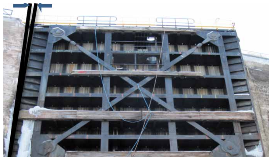
Vue des portes inférieures désalignées de l'écluse 3 de Beauharnois, avant leur remise en état.
