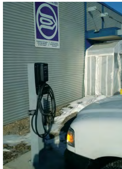
Poste de recharge aux écluses de Beauharnois
