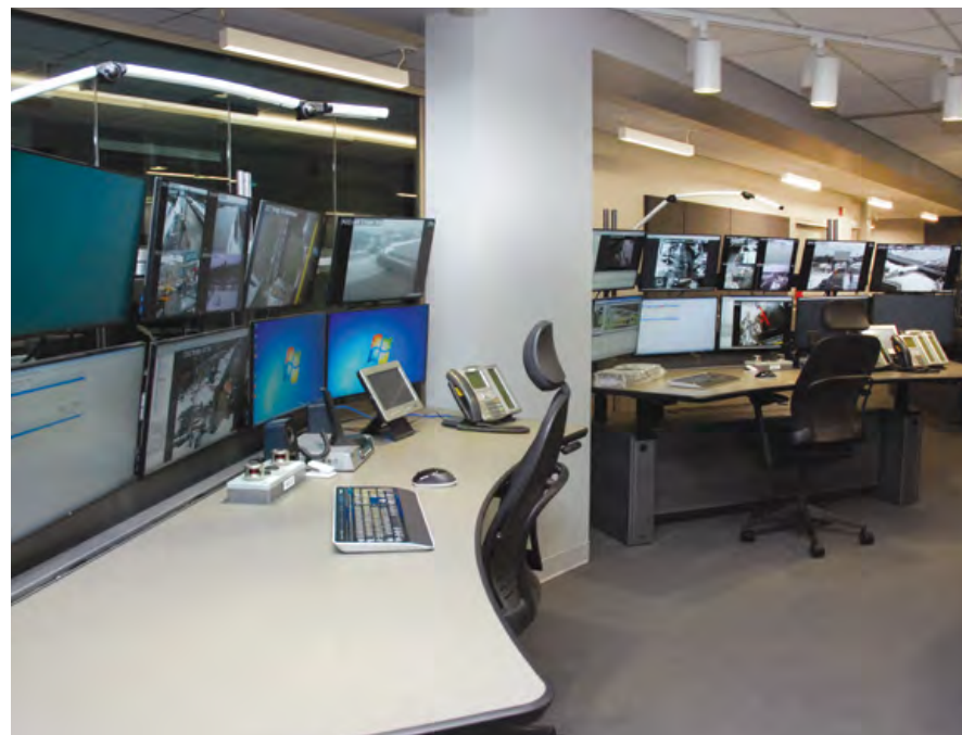
Centre de contrôle des opérations de la Voie maritime à St. Catharines (Ontario)
