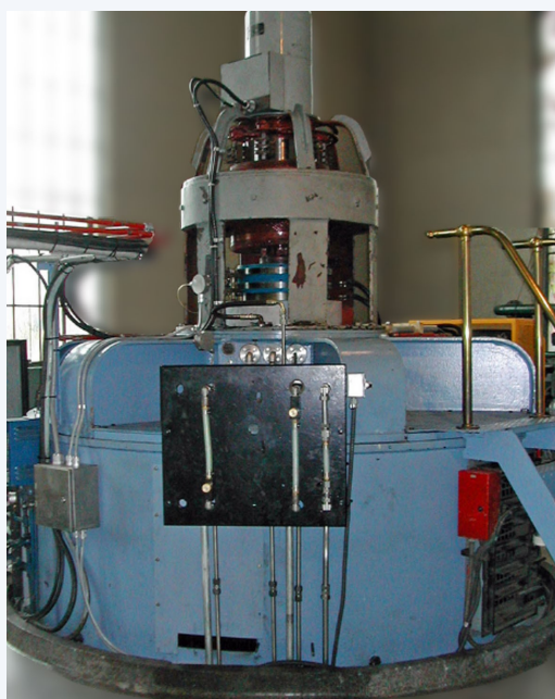
1 des 2 génératrices à l'intérieur de la centrale
